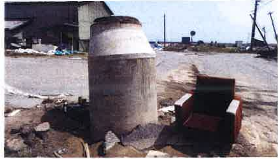
地震の影響で隆起したマンホール
